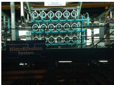
Système de Microfiltration dans une station de traitement NEWater
